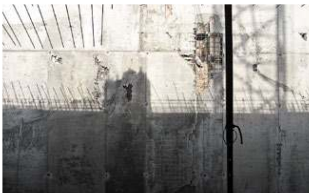
Рисунок 3.1. – Данная железобетонная конструкция непригодна для укладки гидроизоляционных материалов
