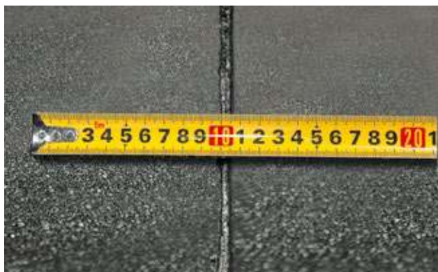
Рисунок 4.10. – Вытек битумного вяжущего из под кромки материала
